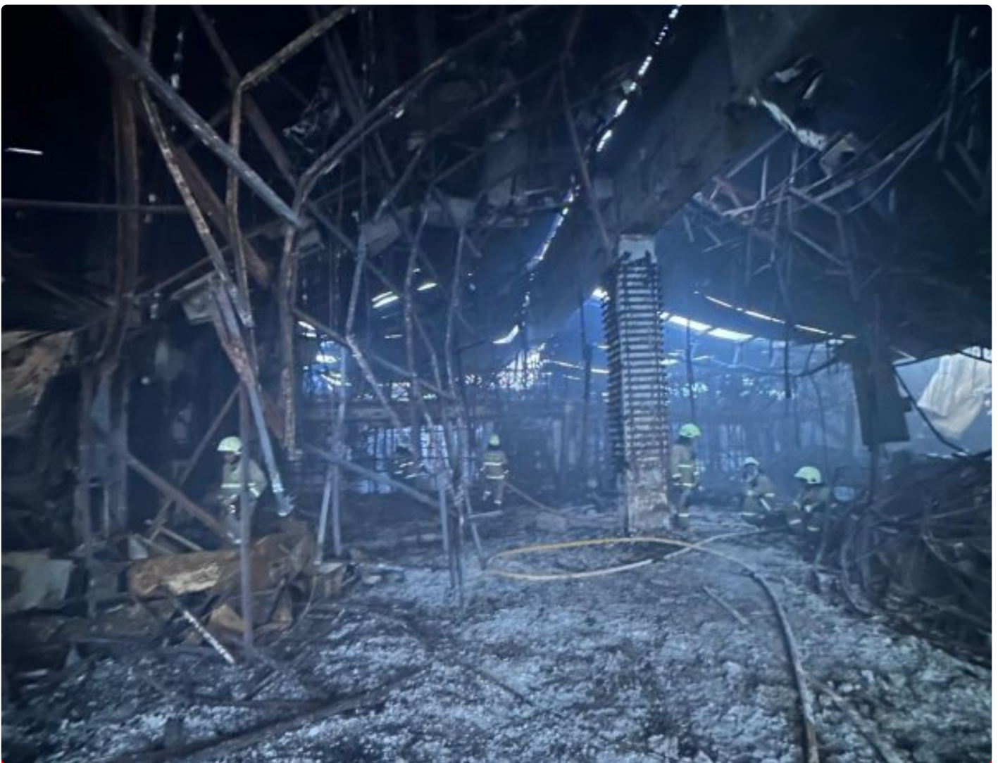
Glodok Plaza yang Hangus Terbakar
